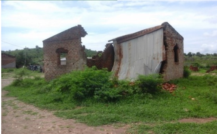
Figura 3 . Destruição da casa devido a vibrações causadas por explosões relacionadas com minas de carvão. Moatize, Tete. Moçambique
